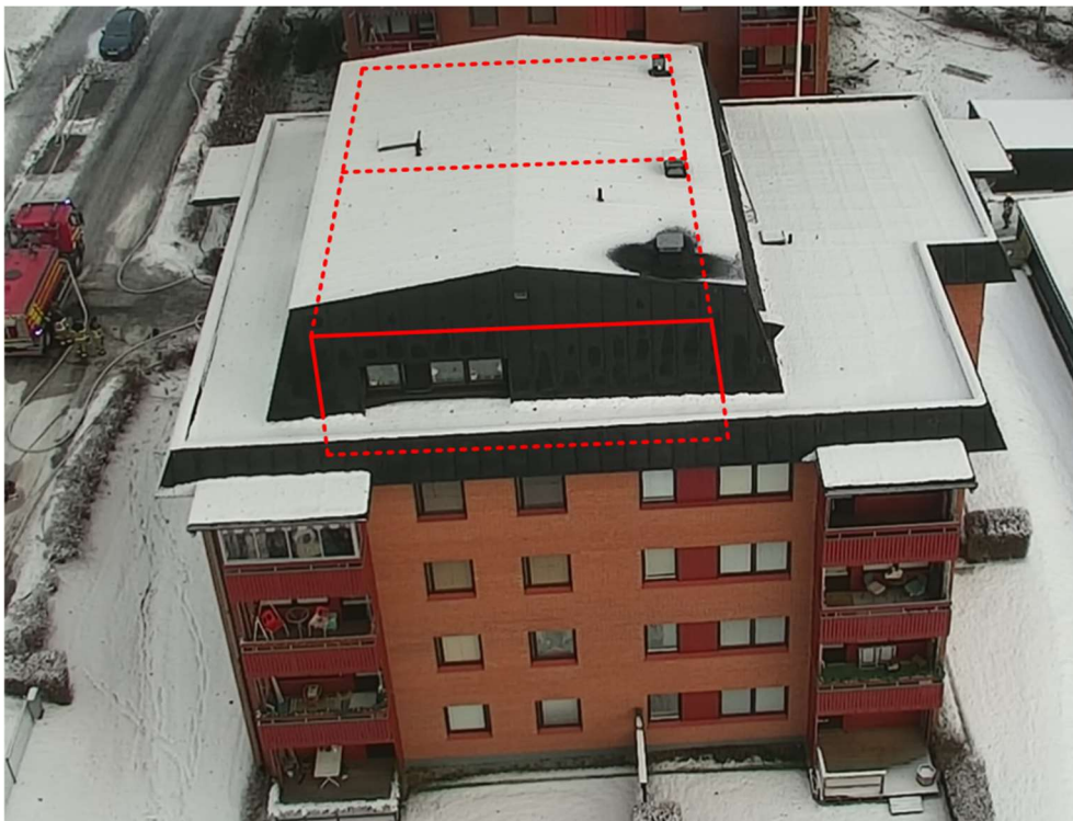
Bild 2 Visar huset bredvid. Röda sträcken illustrerar hur lägenheterna längst upp var placerade och hur takkonstruktionen omgav lägenheterna både bredvid och ovan. Illustrationen är inte skalendig eller exakt beskrivning av placeringen av lägenheterna.
