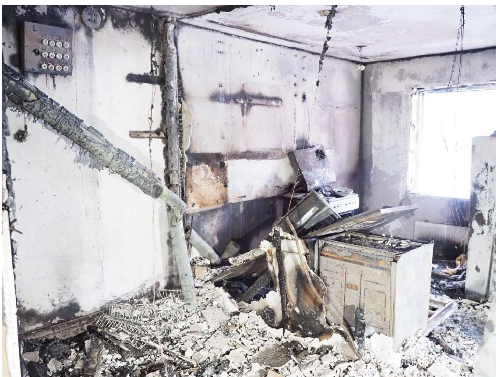
Bild 6 Visar köket. Närmast i bilden är rester från klädkammare. Det har varit en vägg mellan klädkammaren och köket innan branden.
