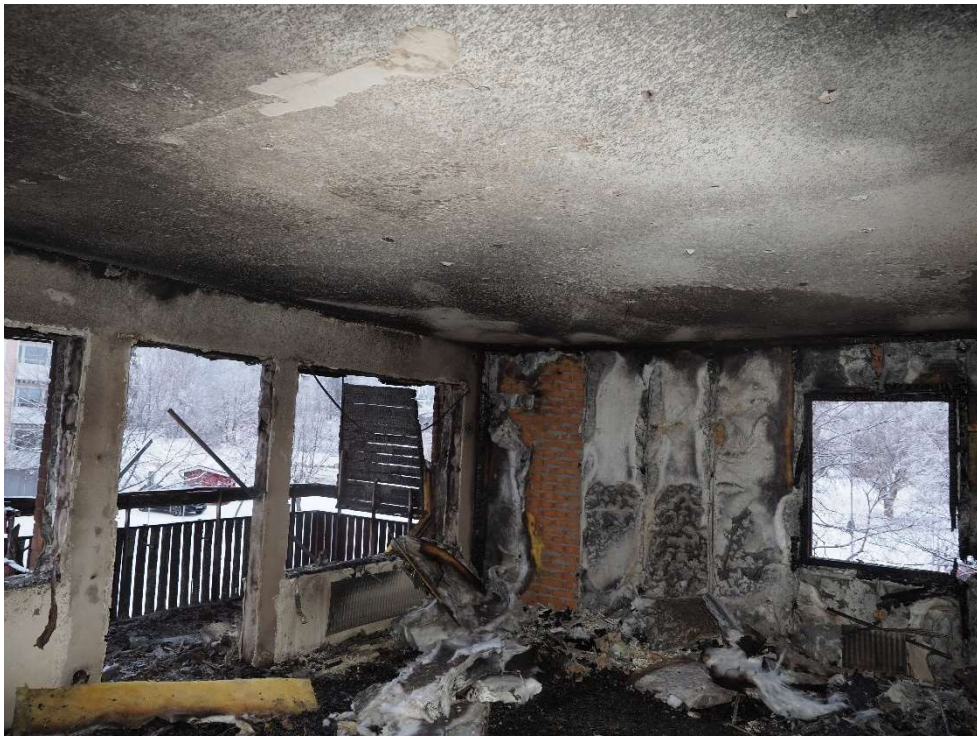
Bild 8 Vardagsrum. Notera området i taket där putsen är helt bortbränd. Detta är samma område som lågor observeras på Bild 7 i tidigt skede.
