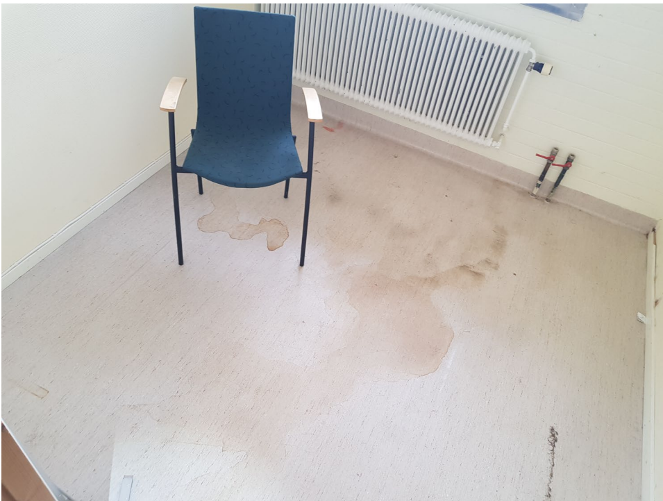
Gym, plan 1 – Fuktskada i golv
