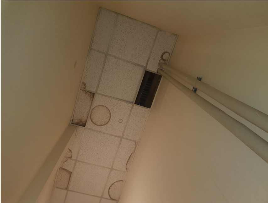
Souterrängplan, trappuppgång mot plan 1 – Spår av läckage i innertaksskivor
