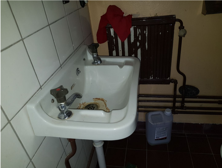
Kemi, plan 2 – Handfat till toalettstol. Läckage i varmvattenkran
