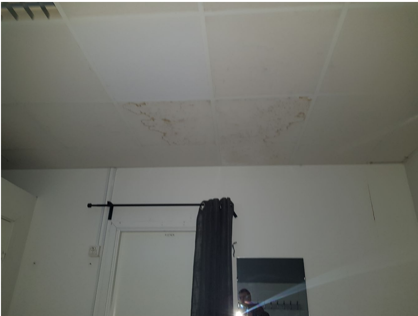
Gym, plan 1 – Fuktskada i innertak i omklädningsrum
