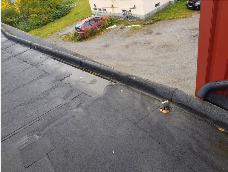
Ovan Gym, norra sidan- Foträna i utkant av yttertaket. Brunn ej i lågpunkt vilket resulterar i vattenansamlingar. Lappning av taket i omgångar
