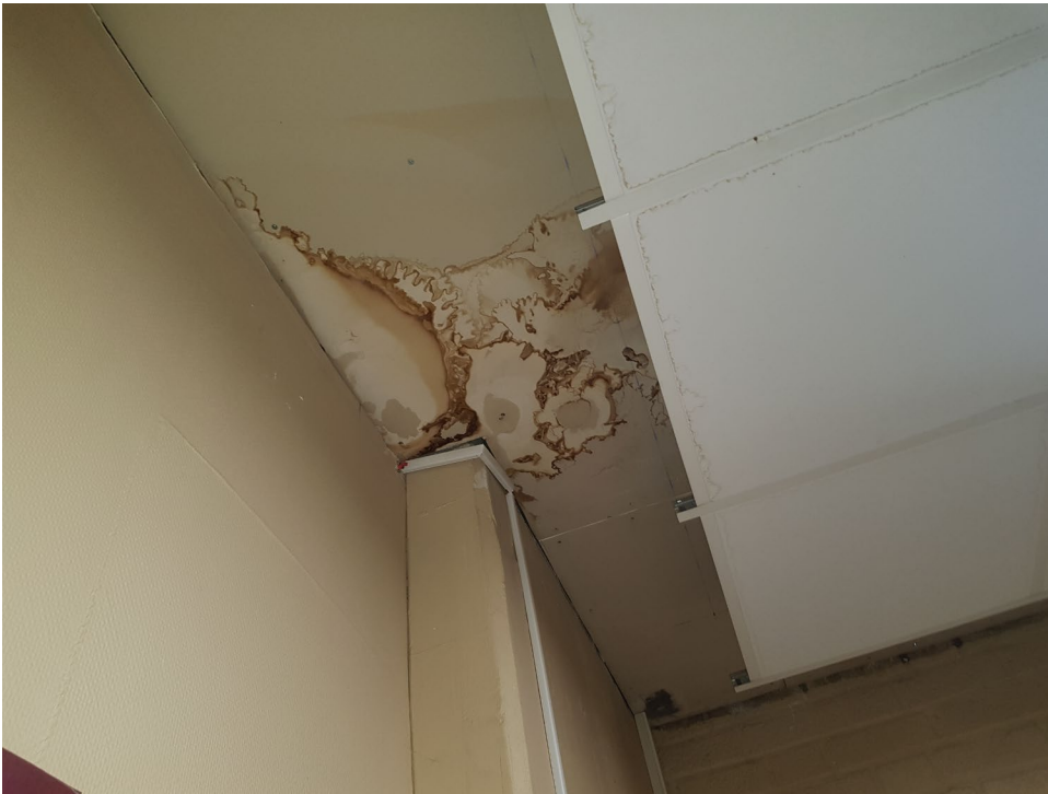
Entré, plan 1 – Pågående fuktskada i innertak. Misstänks komma fram vattenansamling från yttertak
