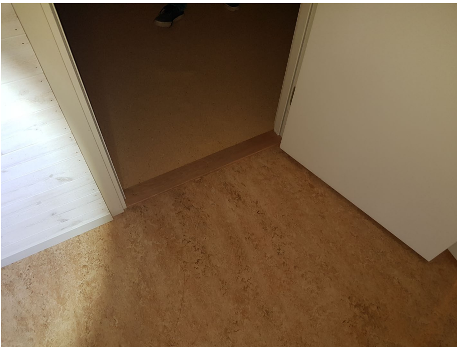
Bizmaker, plan 1 – Fukt indikeras i golv inom delar av kontor samt entrégolv, oklart vad orsaken är. Kan vara från det misstänkta avloppsläckaget som beskrivs på föregående sida
