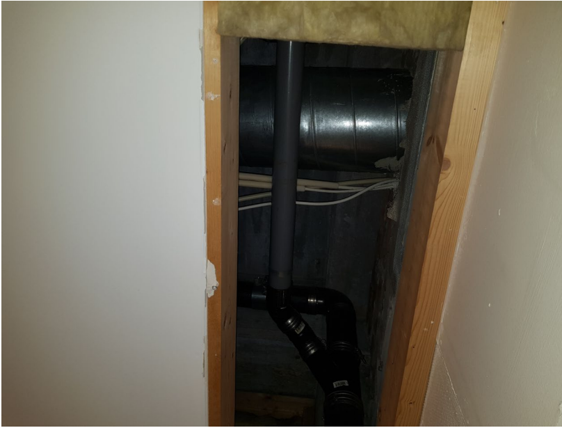
Kontorsmiljö, plan 1 – Upptaget hål i innertak, troligtvis för att åtgärda del av avloppsledning
