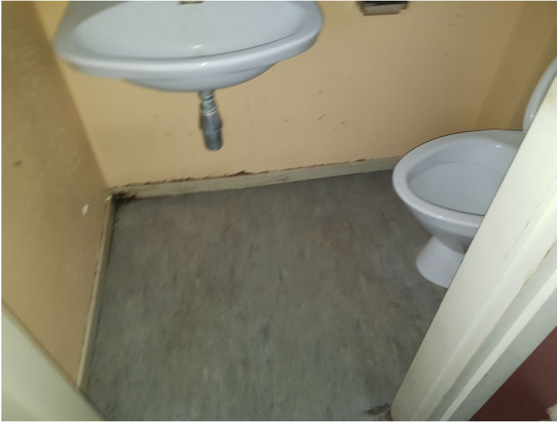
Restaurang, plan 2 – Fukt indikeras i golv inom toalett
