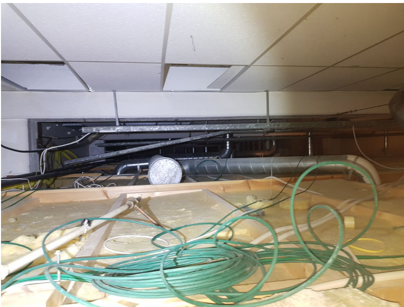
Kontorsmiljö, plan 1 – Frånluftsdon är till synes inte kopplade till någon frånluftskanal utan slutar tvärt i installationsutrymmet
