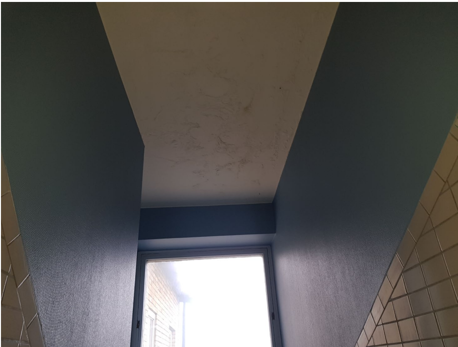
Trapp intill kemi, plan 2 - Fukt i valvet i taket, från läckage i yttertak
