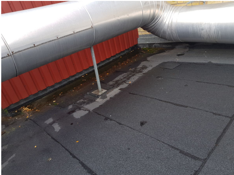
Ovan trapphus/entré i norr – på grund av dålig lutning blir vattenstående. Misstänks vara orsaken till fuktskada i entré
