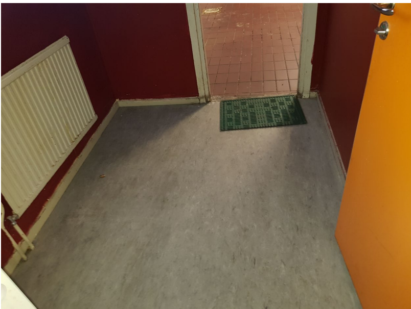
Restaurang, plan 2 – Fukt indikeras i PVC-matta mot köksutrymme
