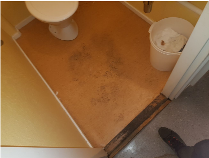
Kontor, plan 2 – Fukt indikeras i golvet samt formförändringar i PVC-matta inom toalett
