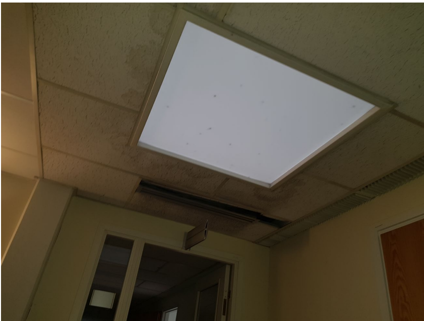
Kontor, plan2 – Fuktskador noteras runt ljusinsläpp
