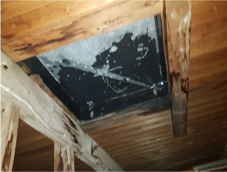
Ovan kontor, plan 2 – Fuktskador runt inspektionslucka mot yttertak
