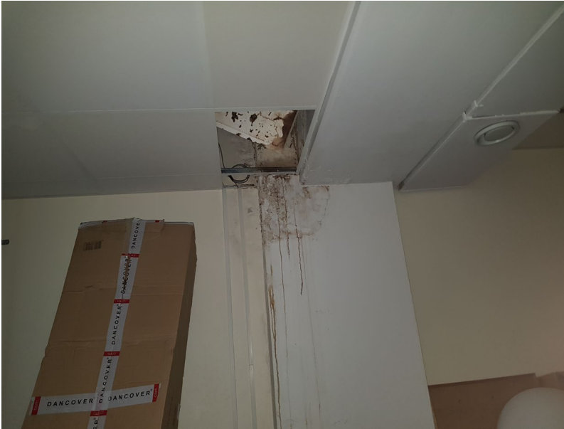
Förråd i östra delen av fastigheten, souterrängplan – Gammalfuktskada som ej är åtgärdad
