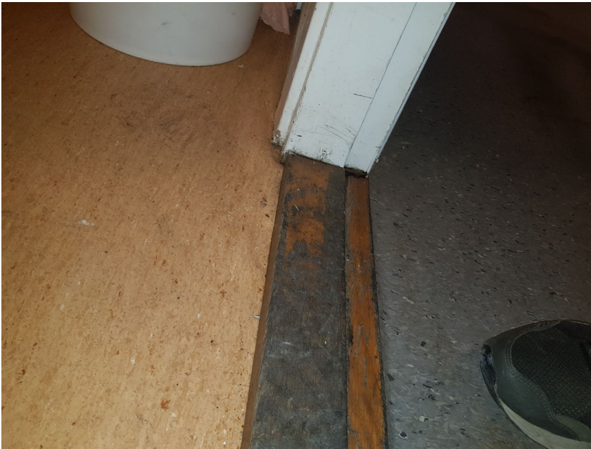
Kontor, plan 2 – Fukt indikeras i golvet samt formförändringar i PVC-matta inom toalett
