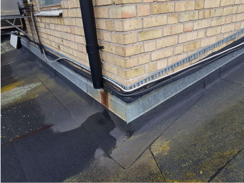
Ovan Gym – Avslutande vinkel saknas på stuprör
