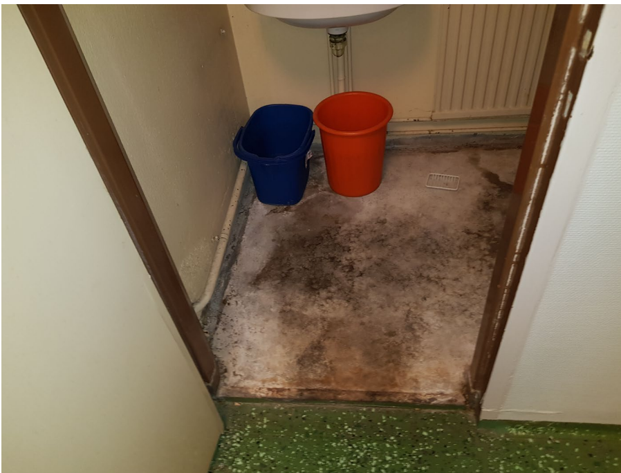
Restaurang, plan 2 – Toalett där fukt indikeras i golv, PVC-mattan redan uttriven
