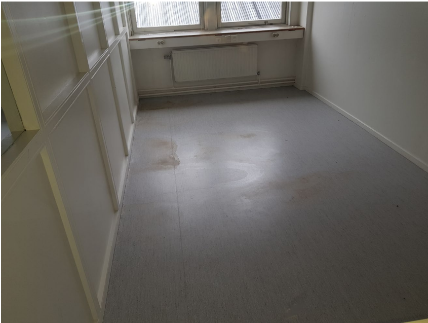
Kontor, plan 2 – Fuktskador noteras runt fönster samt i golv
