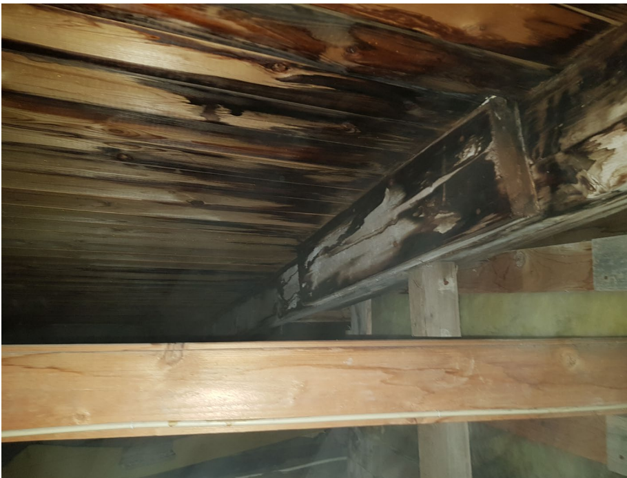
Ovan kontor, plan 2 – Fuktskador runt ljusinsläpp
