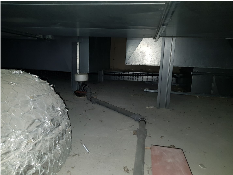
I fläktrum - Kondensavvattning till avluftningsledning för avlopp
