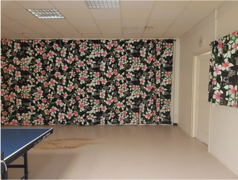
Kontorsmiljö, plan 1 – Pausrum med pingsbord, skador i innertak samt fuktindikationer i golvet
