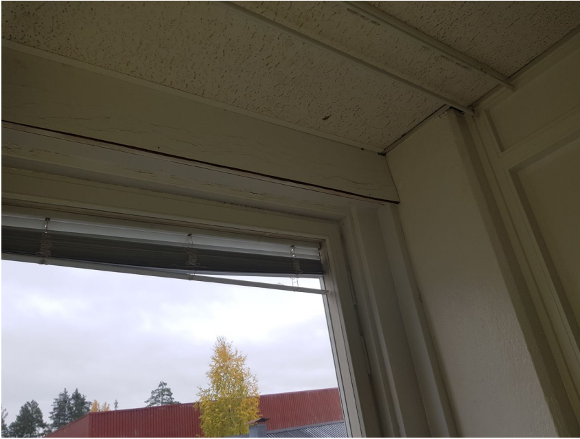
Kontor, plan 2 – Fuktskador noteras runt fönster
