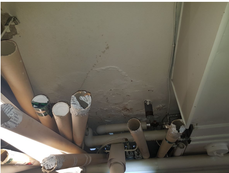
Senad, souterrängplan - Spår av läckage
