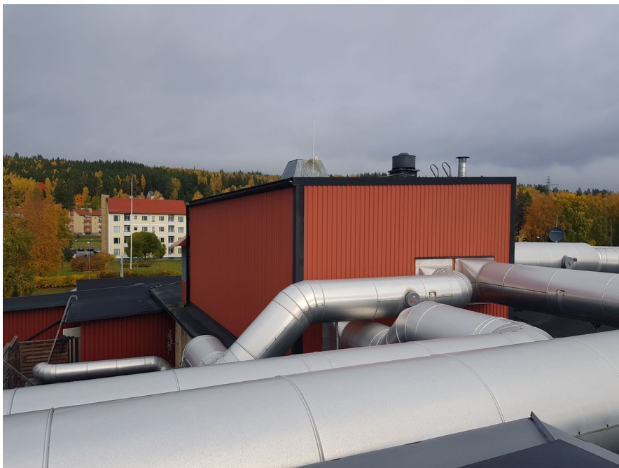
Yttertak – bild på fläktrum
