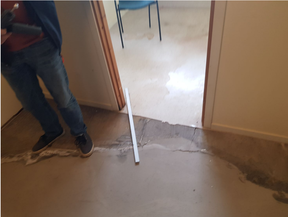
Gym, plan 1 – Fuktskada i golv inom hall samt i rum ytbelagd med PVC-matta
