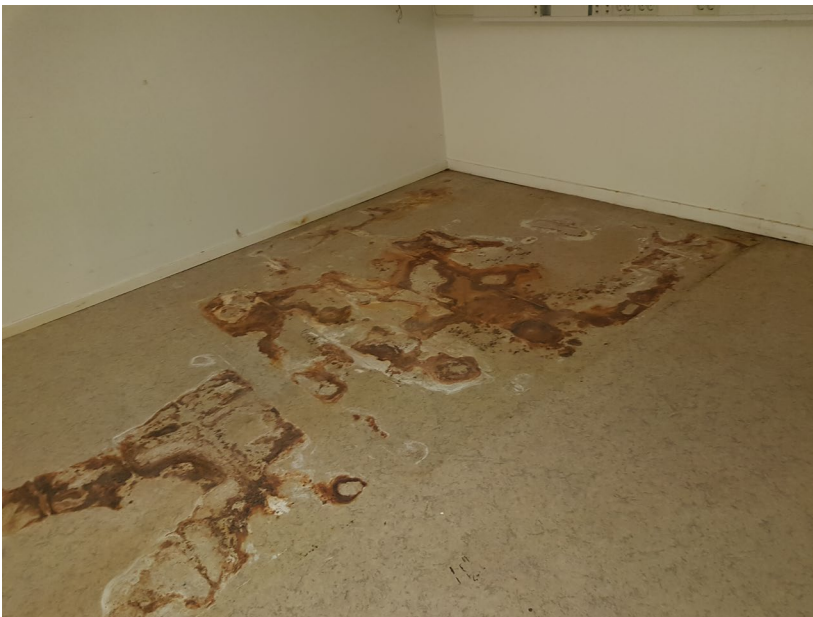
Restaurang, plan 2 – Skador i golvmatta från verksamheten
