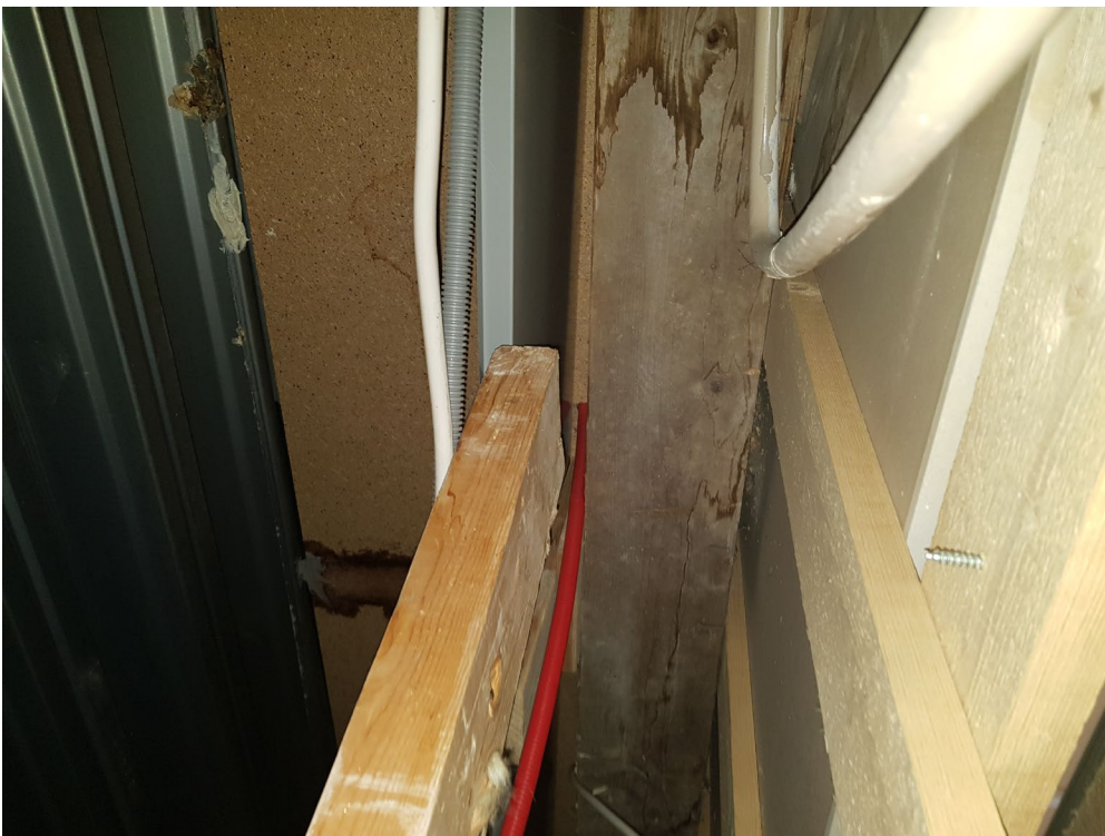
Entré, plan 1 – Pågående fuktskada i innertak. Misstänks komma fram vattenansamling från yttertak, bild ovan innertak
