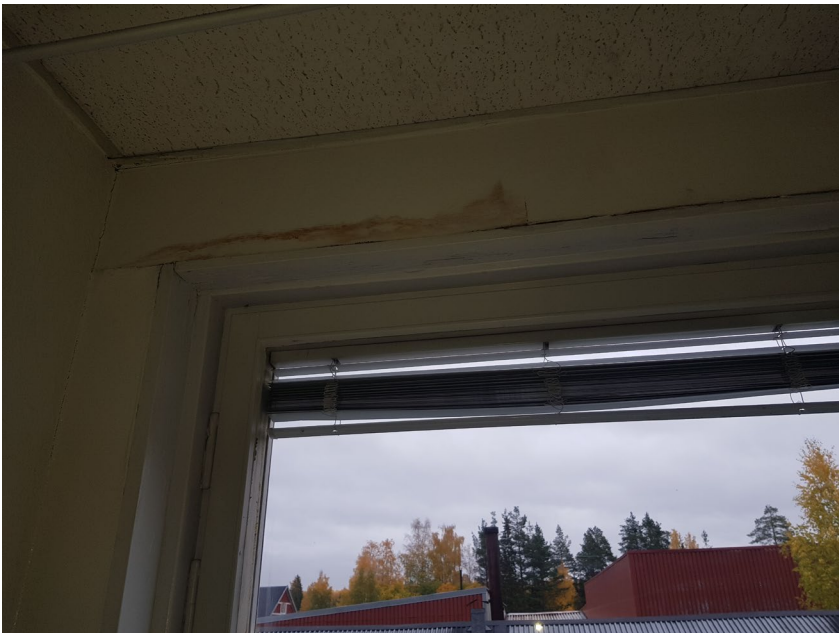
Kontor, plan 2 – Fuktskador noteras runt fönster
