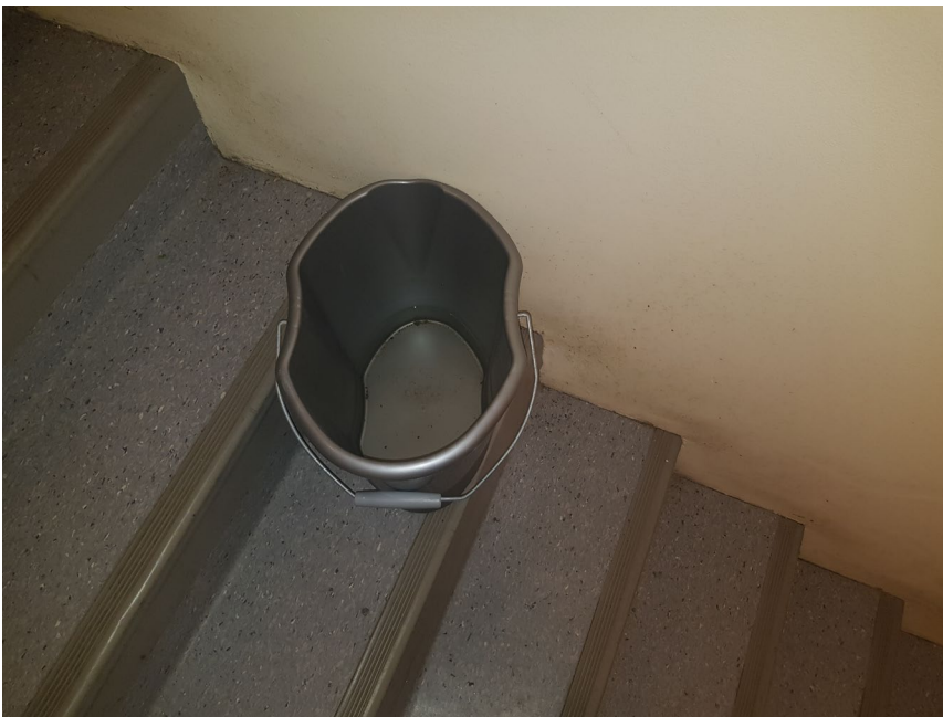
Souterrängplan, trappuppgång mot plan 1 – Hink för uppsamling av läckage från taket
