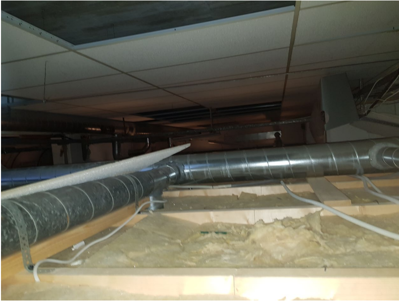
Kontorsmiljö, plan 1 – Installationsutrymme mellan nedpendlat innertak och tidigare innertak
